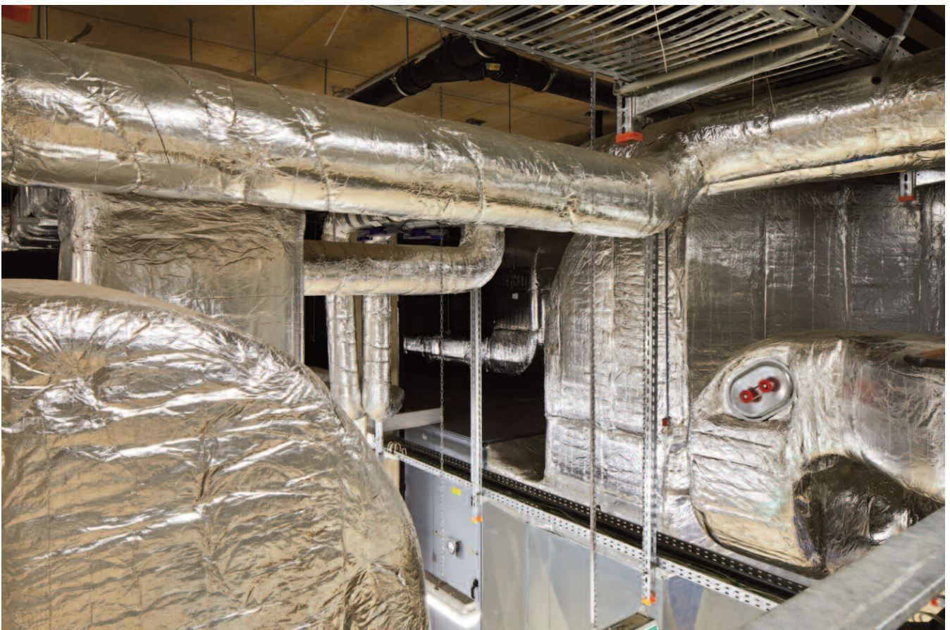
Abbildung 4: Die Lüftungsanlage –Ein Schwergewicht bei der Energieeffizienz
