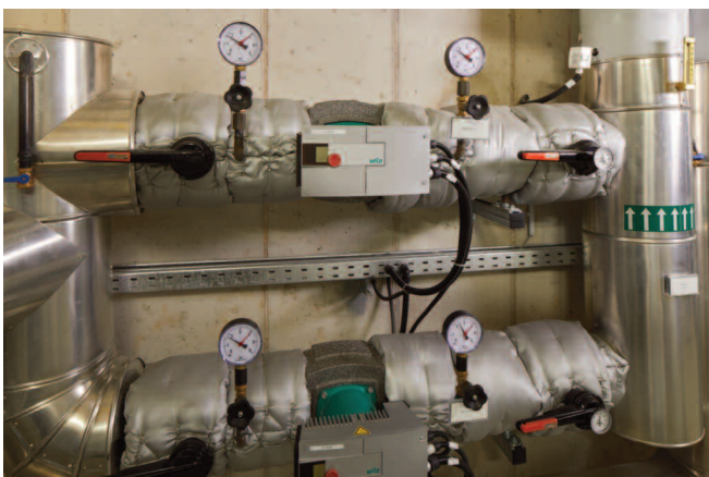
Abbildung 3: Die Heizungsanlage – Hier wird Wärme produziert
