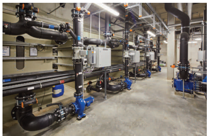
Abbildung 2: Wasseraufbereitung im Hallenbad
